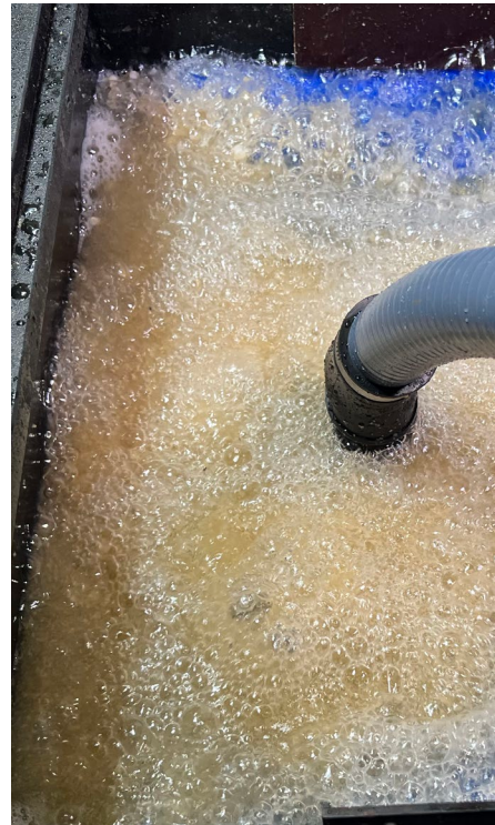
Kolmatierter Biofilter während RS
