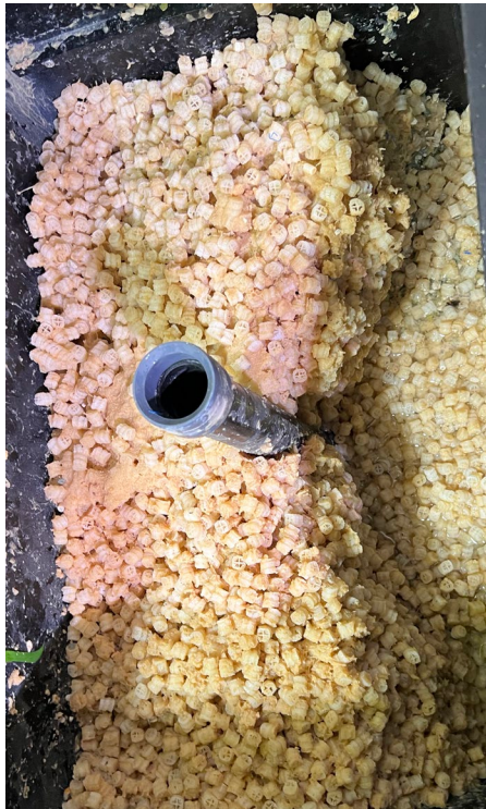
Kolmatierter Biofilter vor RS
