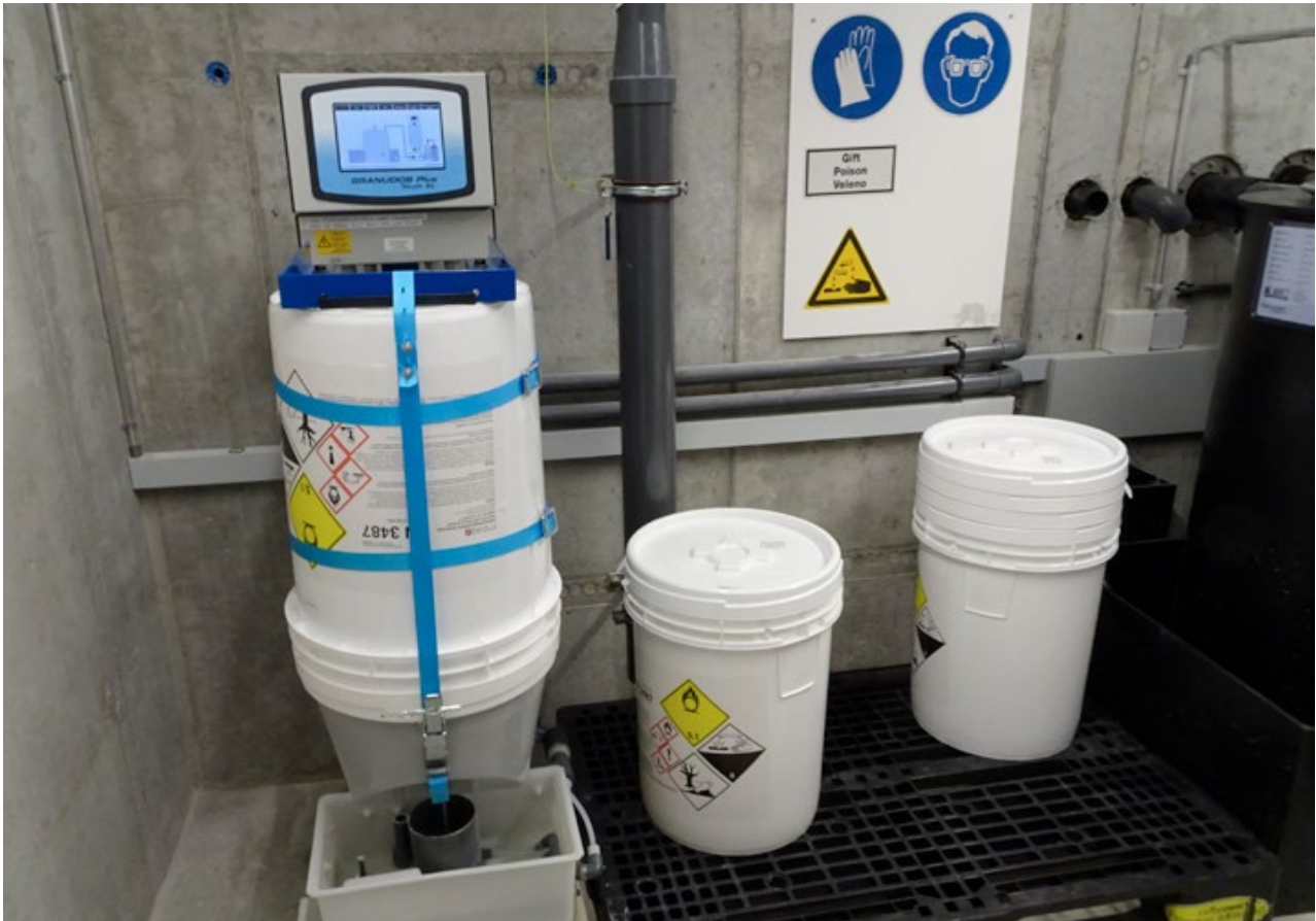
Foto 1: Dosierstation mit Chlorgranulat (Calciumhypochlorit)
