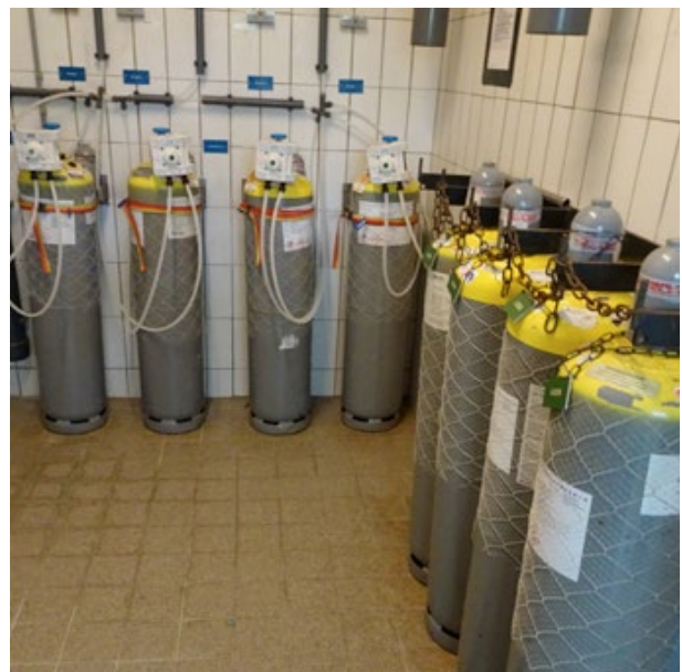
Foto 2: Störfallbetrieb mit Chlorgasanlage
